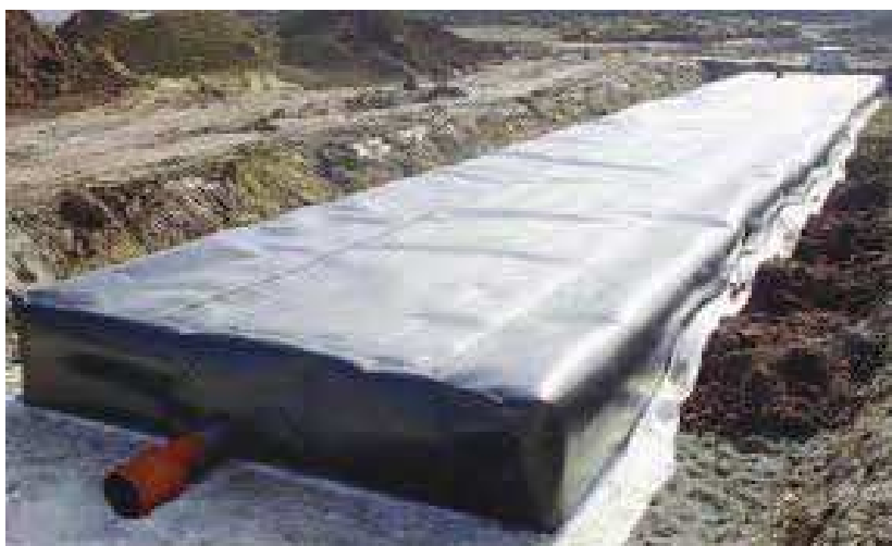
Bild 4: Verschweißte Rückhalteeinrichtung aus Speicherboxen mit Reinigungskanal
